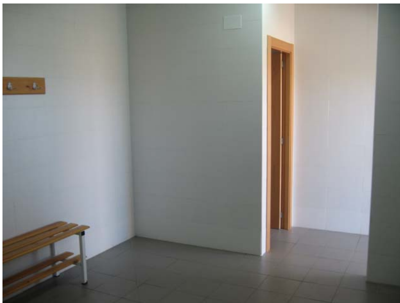
FOTOS DE ASEO DE VESTUARIOS. SE MODIFICARÁ PARA ACERLO ACCESIBLE (SEGUNDA ZONA)
